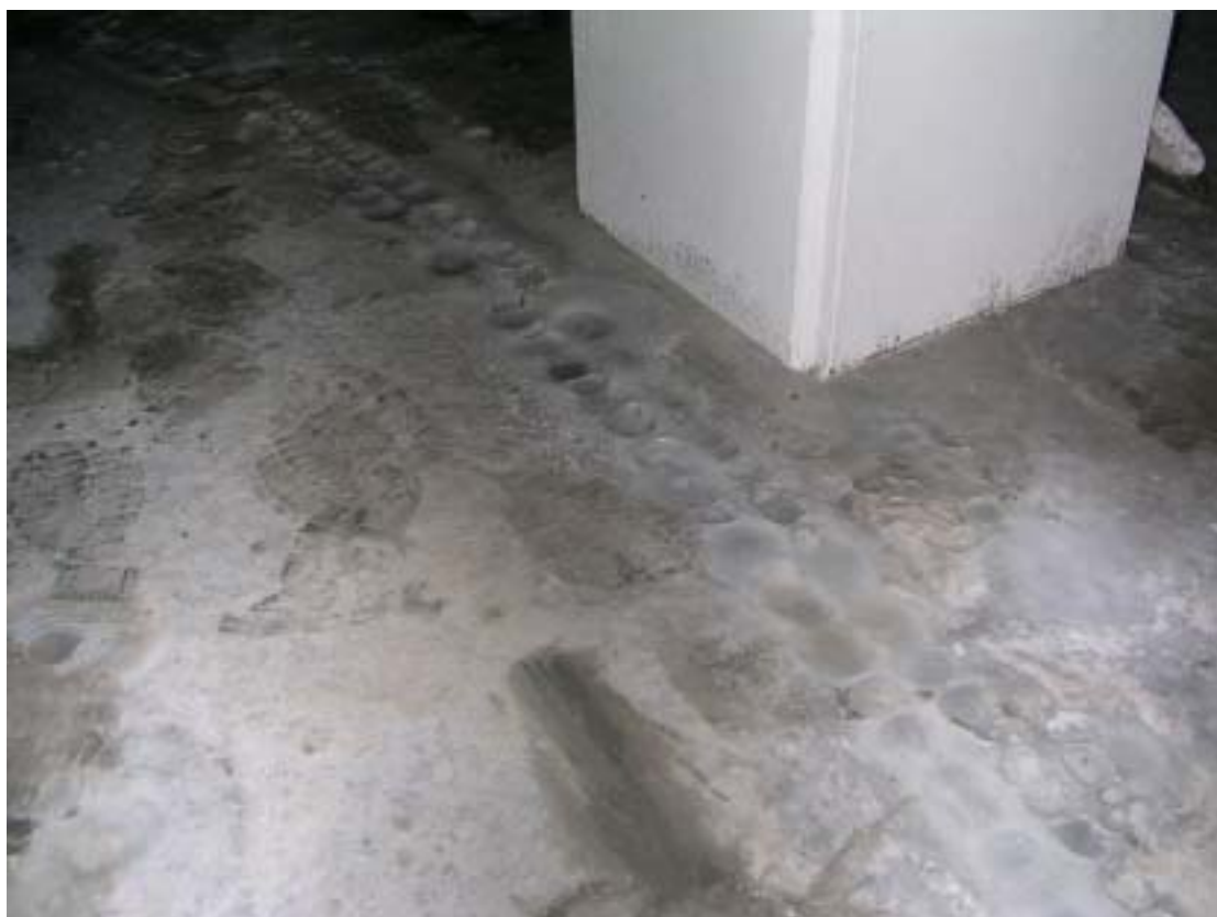
圖十三：下乾井底部累積混凝土漿情形
