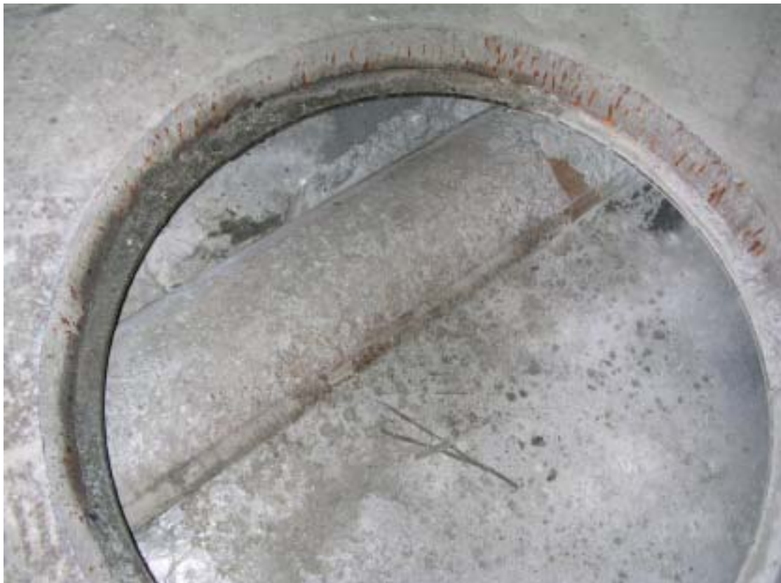
圖十六：混凝土表面乾燥養護作業有待加強情形
