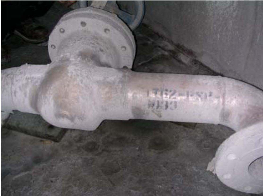
圖十五：管閥設備泡水及受混凝土污染情形
