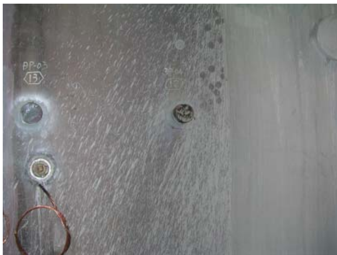
圖十二：混凝土漿浮水逸流噴濺情形
