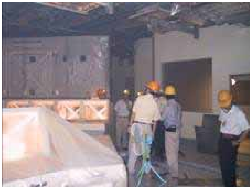
圖13：一號機控制室設備視察(一)
