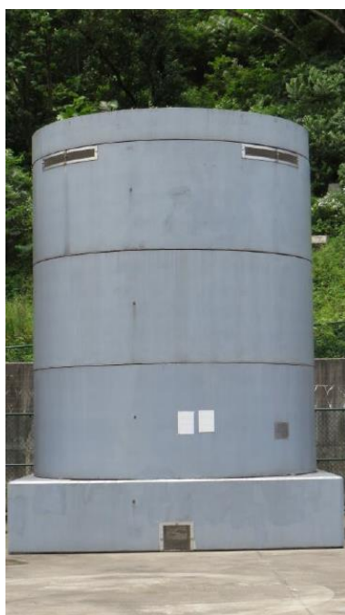
圖 16.5 核一廠 INER-HPS 乾式貯存護箱外觀
