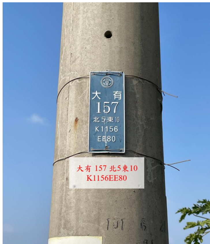
圖 67 DCU 之安裝桿號(饋線 XD35)
