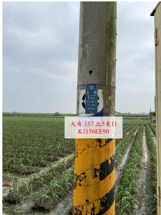
圖 64 TTU 之安裝桿號(饋線 XD35)
