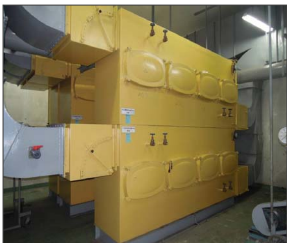
舊有中負壓系統絕對過濾箱體
