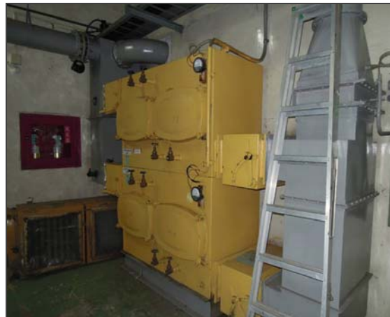
舊有高負壓系統絕對過濾箱體
