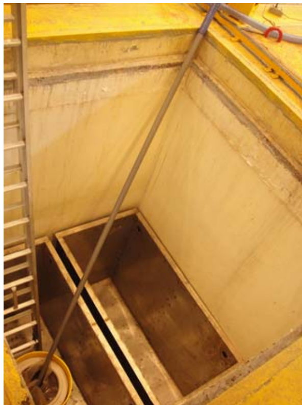
地下高活度廢樹脂取出設備熱測試
