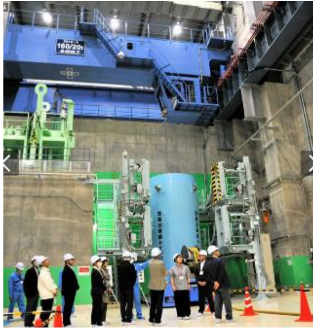
圖 27 貯存設施內部樣貌，下方淺藍色圓柱體為訓練用護箱，上方有一 160 噸天車[17]
