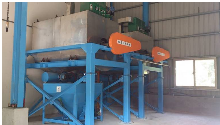
混凝土障壁材料骨材乾燥設備
