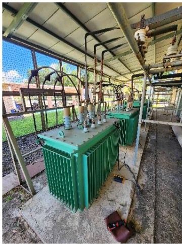
(a) 本院館舍之變壓器
