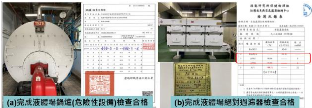
圖 2-21、完成液體場(a)鍋爐年度檢查合格，以及(b)絕對過濾器更換
