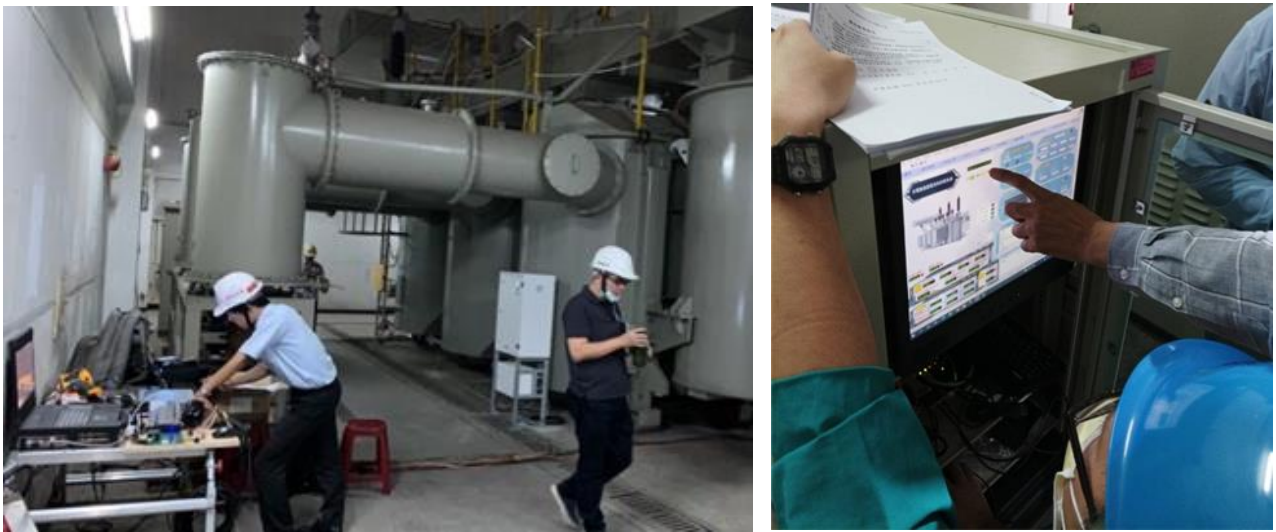
圖 23 實際安裝於變電所
