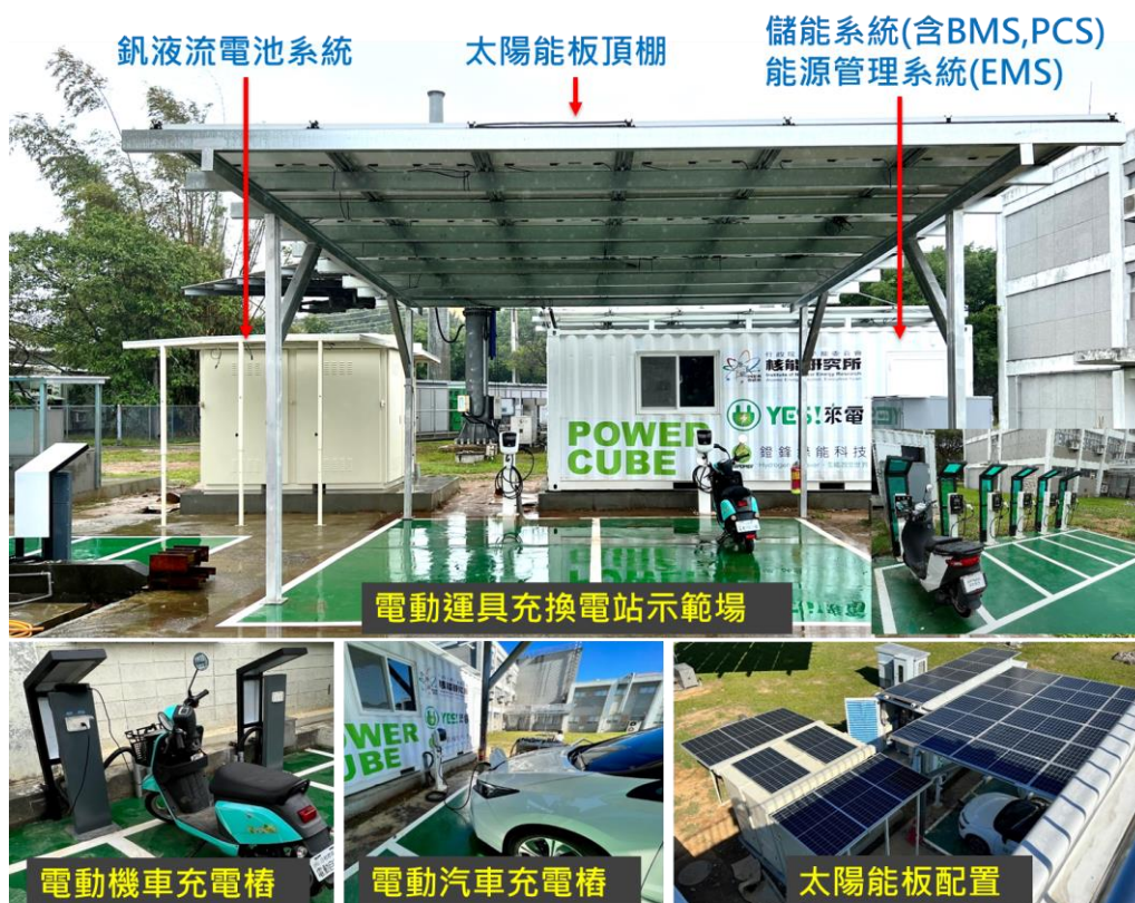
圖 18 電動運具智慧充換電儲能電站示範場
