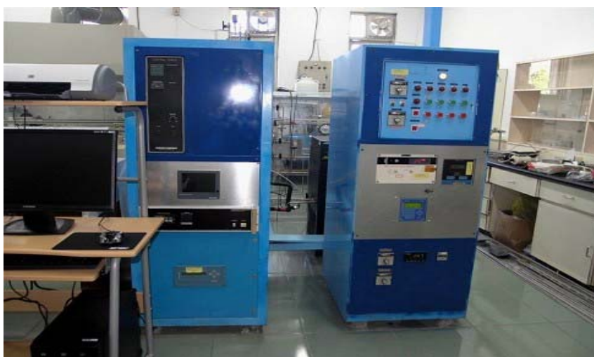
圖 2 水環路水質監視設備
