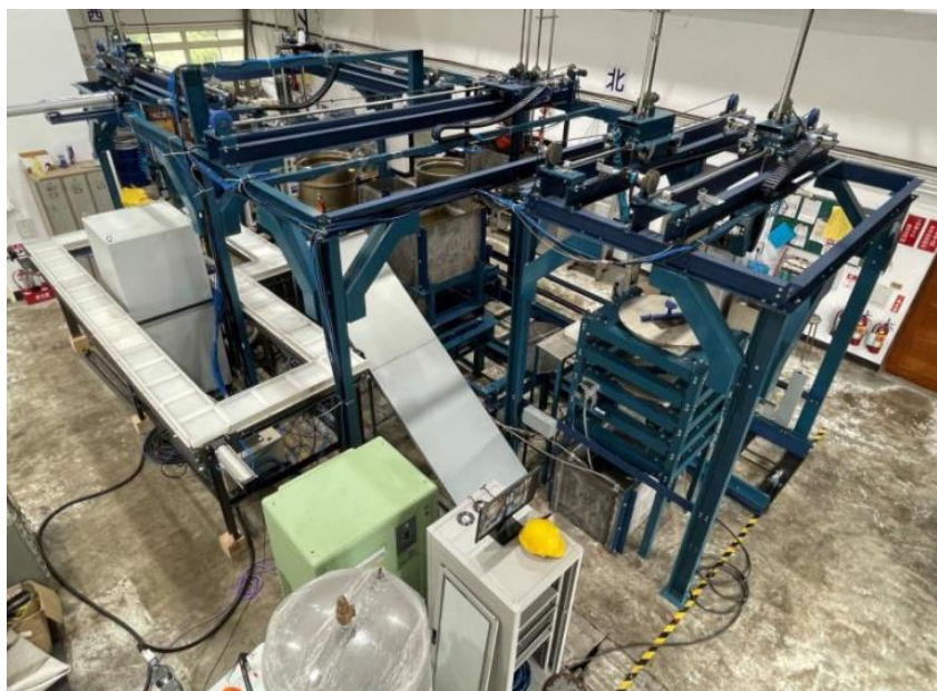
圖 2-20、完成建置遙控與自動化樹脂安定化設備
