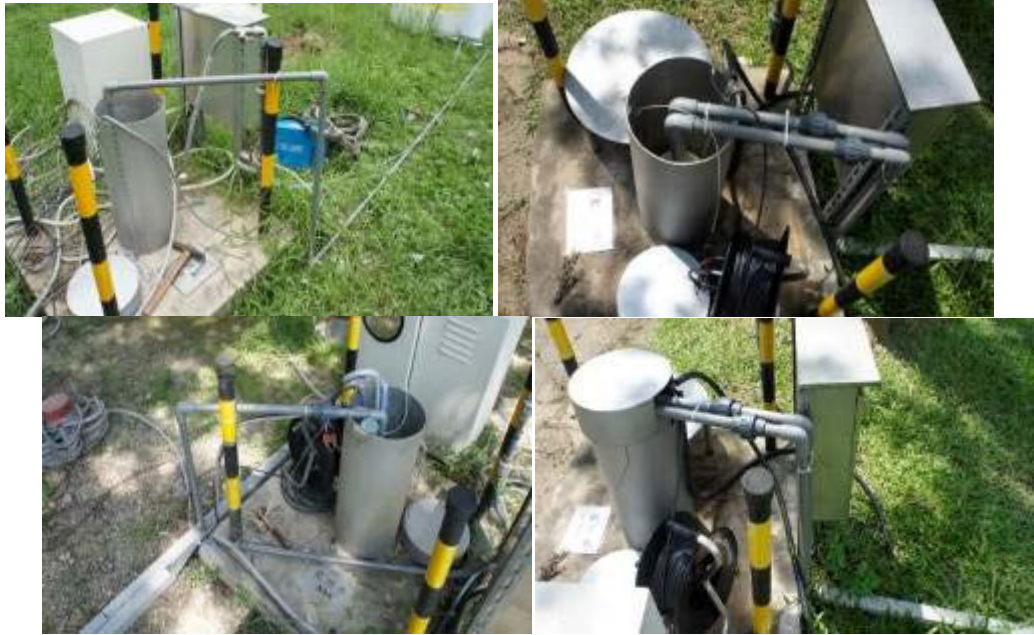
地下水抽/處理/灌系統－抽水與處理後回注
