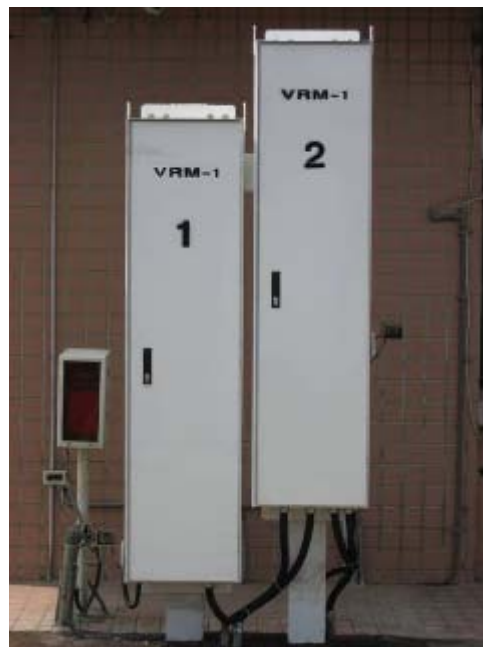
新架設於 3 號門出所的自製工業電腦式 VRM-1 車輛門框監測系統
