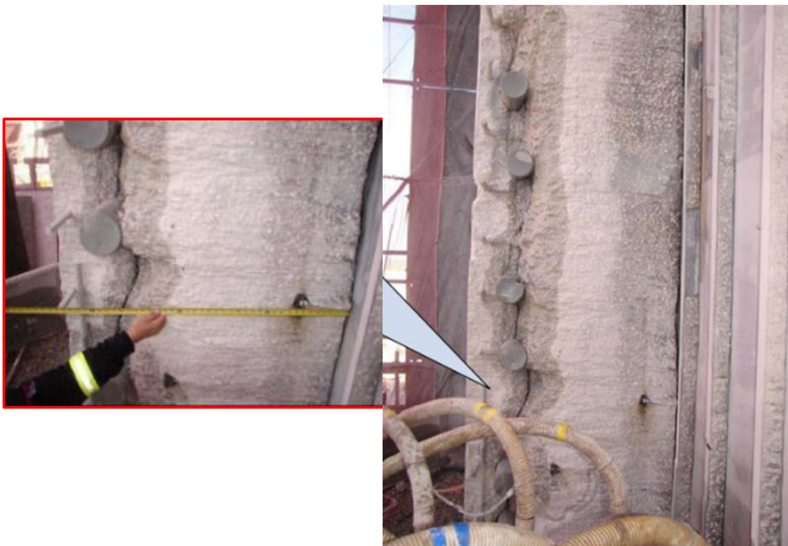
圖 2.9 鋼鍵套管和內襯之間的混凝土牆體存有垂直裂縫
