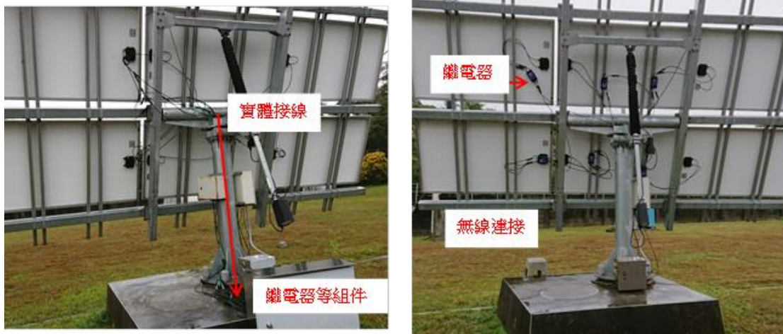
圖14、原本(左)與改良後(右)的太陽能模組自動檢測設備，改用無線通訊並直接以模組供電，省去實體接線。
