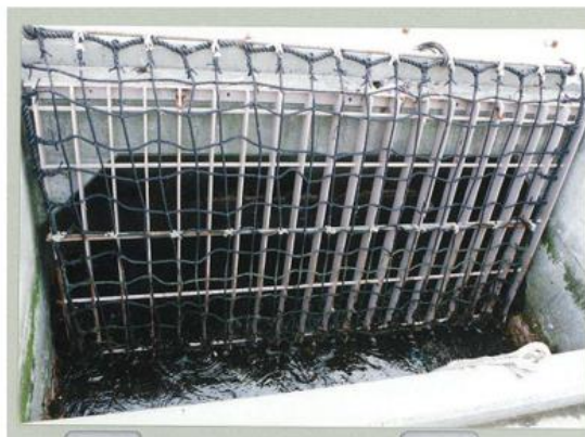
圖 3-34 女川 1 號機-固定式柵欄過濾網
