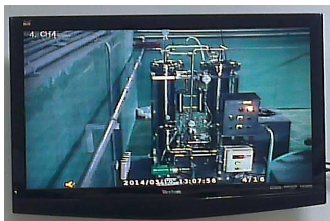
放射性廢水處理實廠測試設備
