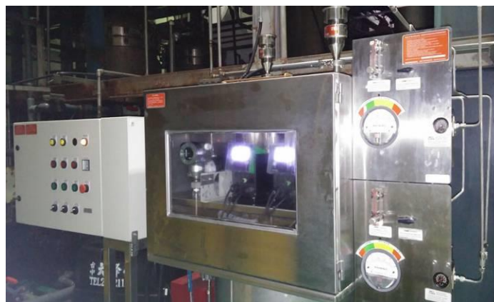
放射性有機廢液輔助焚化處理系統
