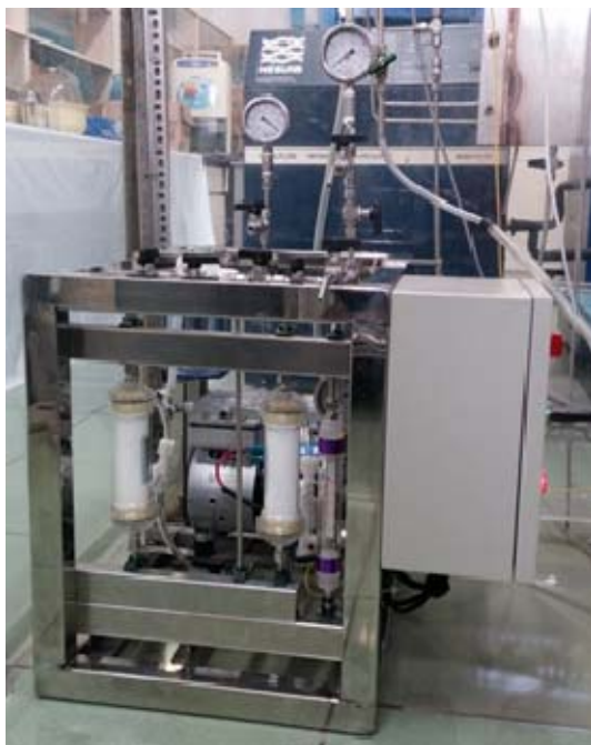
水環路之脫氧膜設備白色部分即為脫氧膜
