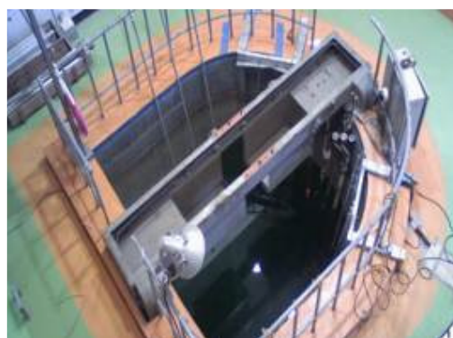
控制棒驅動組件拆卸後
