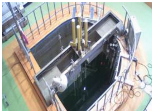
控制棒驅動組件拆卸前
