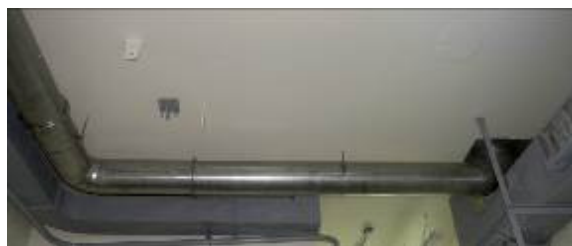
地下室高負壓新風管
