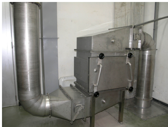
地下室高負壓空通調風新過濾箱體
