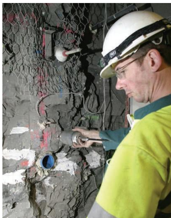
坑道壁中的感測儀器晝夜不停地監測岩層狀態。
