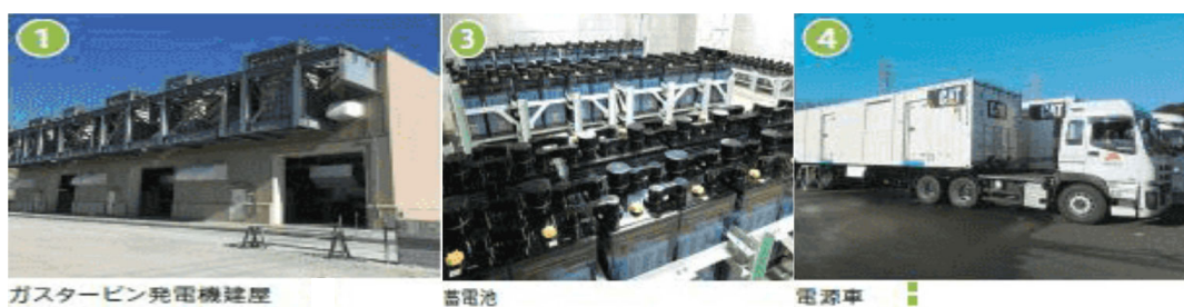
圖 4-69 燃氣發電機、蓄電池、發電車
