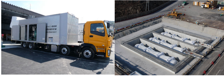
圖 4-49 緊急用燃氣渦輪發電機與電源移動設備 (Tohoku Electric Power Co., 2019)
