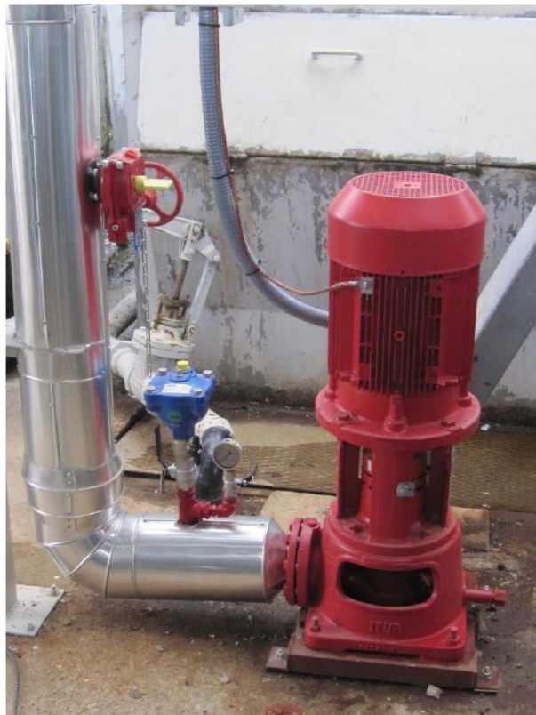
圖 1-17 消防系統的新幫浦
