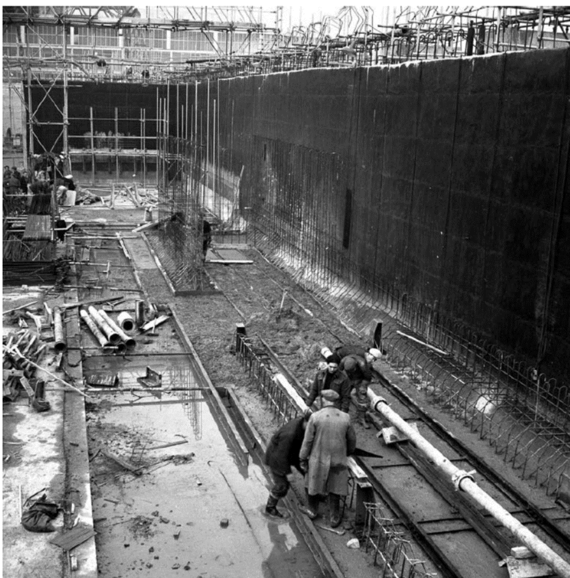
圖 1-6 1948 年在英國 Sellafield 建造的 pile 用過燃料貯存池
