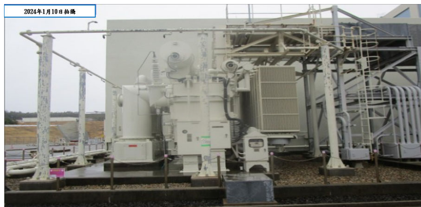
圖 3-84 2 號機備用電源變壓器（北陸電力株式會社）
