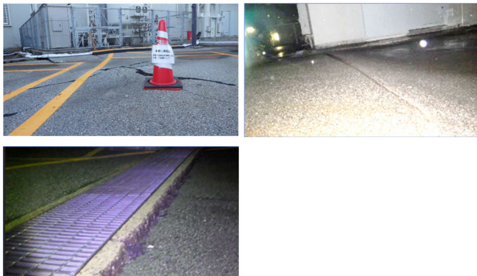
圖 3-91 高壓電源車通道的段差（北陸電力株式會社）
