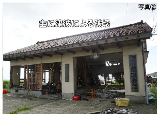
圖 3-56 消防局駐地受海嘯破壞 b
