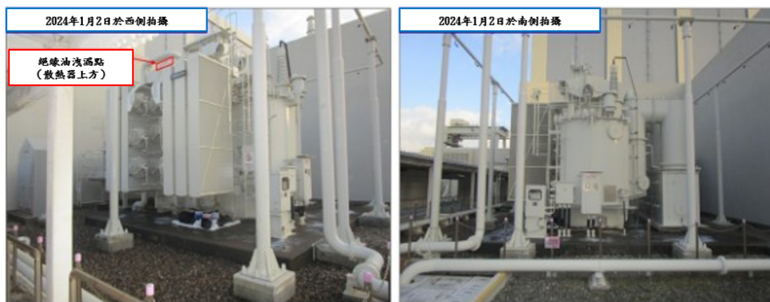
圖 3-75 1 號機啟動變壓器（北陸電力株式會社）
