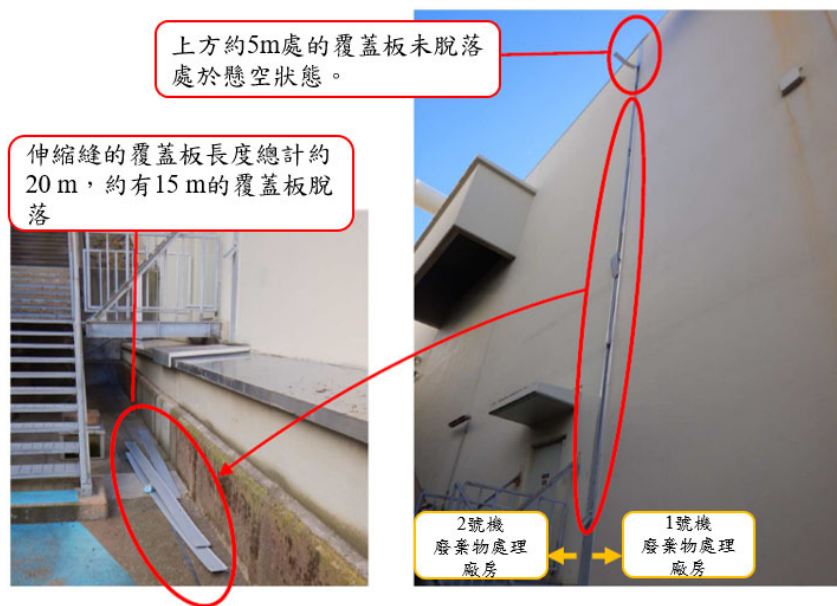
圖 3-92 1 號機與 2 號機垃圾處理廠房伸縮縫覆蓋板脫落 （北陸電力株式會社）
