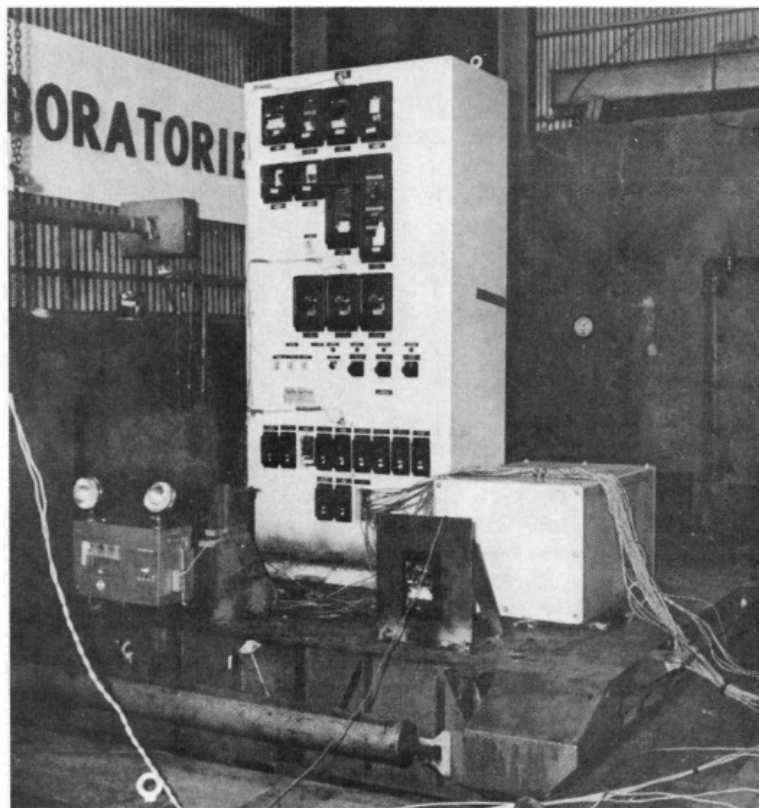
圖 2-40 安裝於振動台上之 4.16kV 開關裝置、保護電驛、緊急照明電池組、電壓互感器、電池 (NUREG/CR-4899, p. 3-47)
