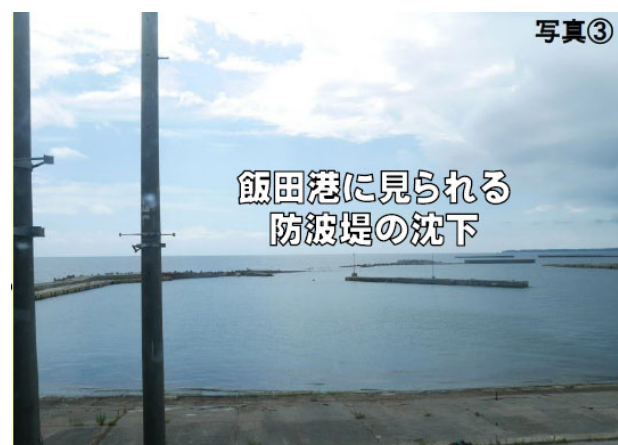
圖 3-57 飯田港防波堤沉陷
