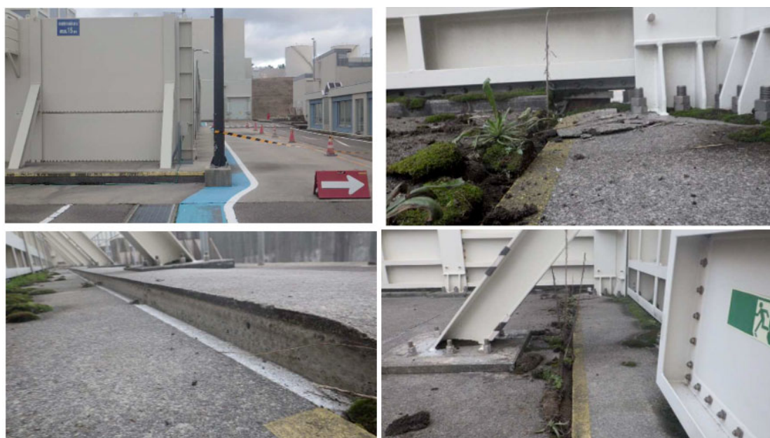
圖 3-89 1 號機組防洪牆基礎與地基間的空隙（北陸電力株式會社）
