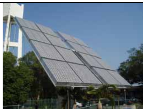
圖七：5 kWp HCPV 系統
