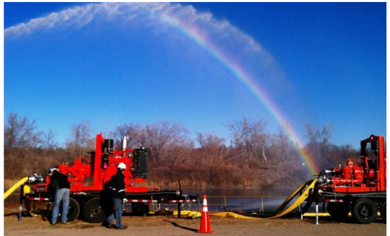
圖 4: Monticello 核能電廠人員測試新購之移動式泵浦 (資料來源: NEI 2013 年白皮書 5 )
