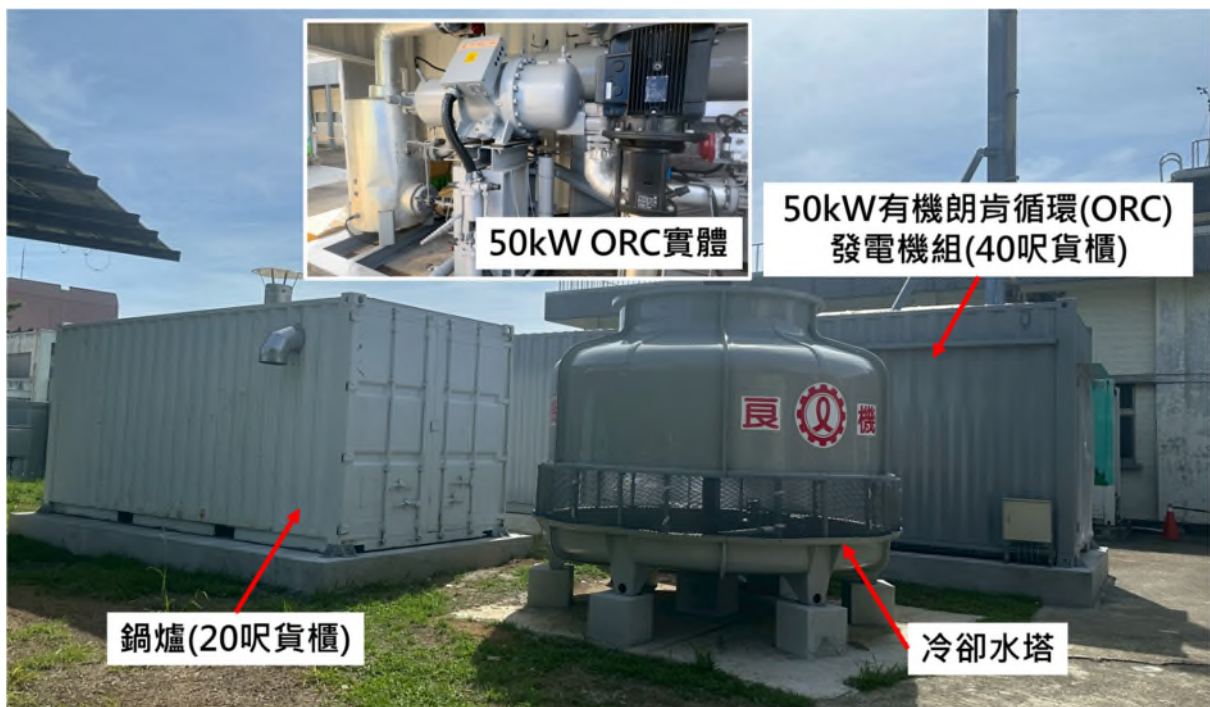
圖 5-6、完成 50kW 熱電能轉換模組實體建置
