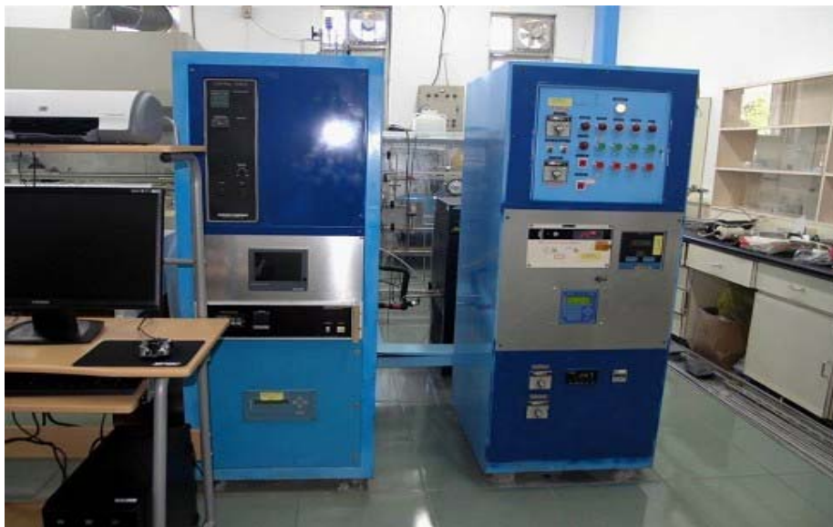
圖 6-2 水環路水質監視設備
