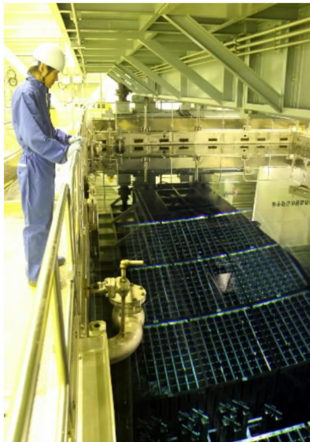
圖 3-5 島根 1 號機的用過燃料池 11
