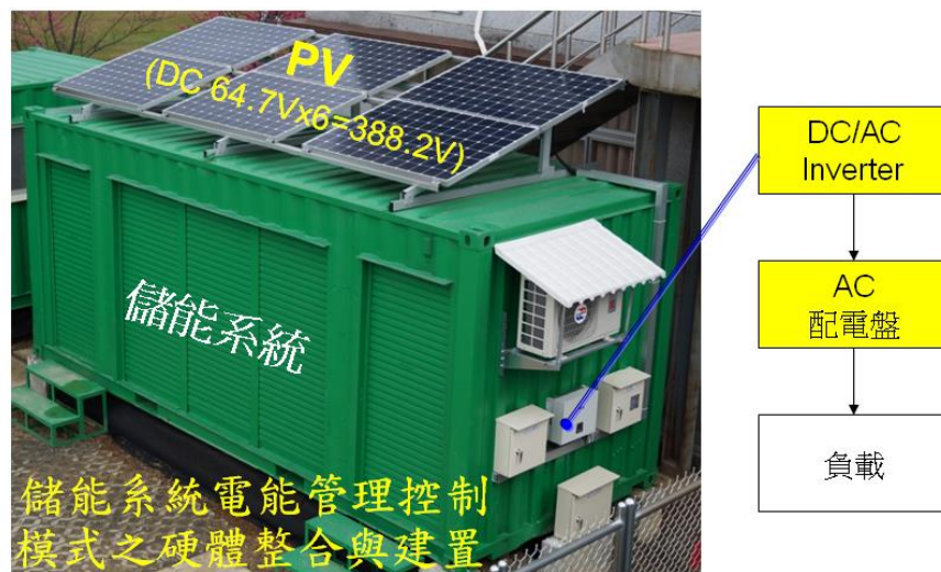
圖 23：儲能系統之電能管理控制模式硬體整合與建置
