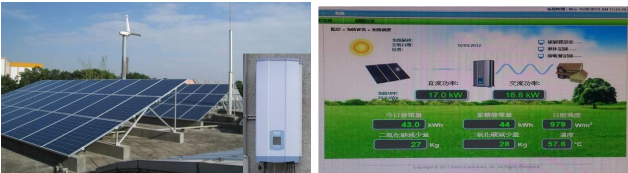
圖十四、20kW 之 PV 系統建置
