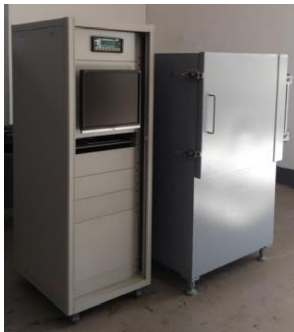
圖 2-10、土壤輻射量測系統箱體及電腦控制機櫃
