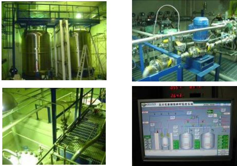
圖 1-2-1、高活度廢樹脂移貯系統設備安裝於 012 館 023 房內
