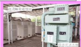
120 kW合成氣發電能源利用系統
