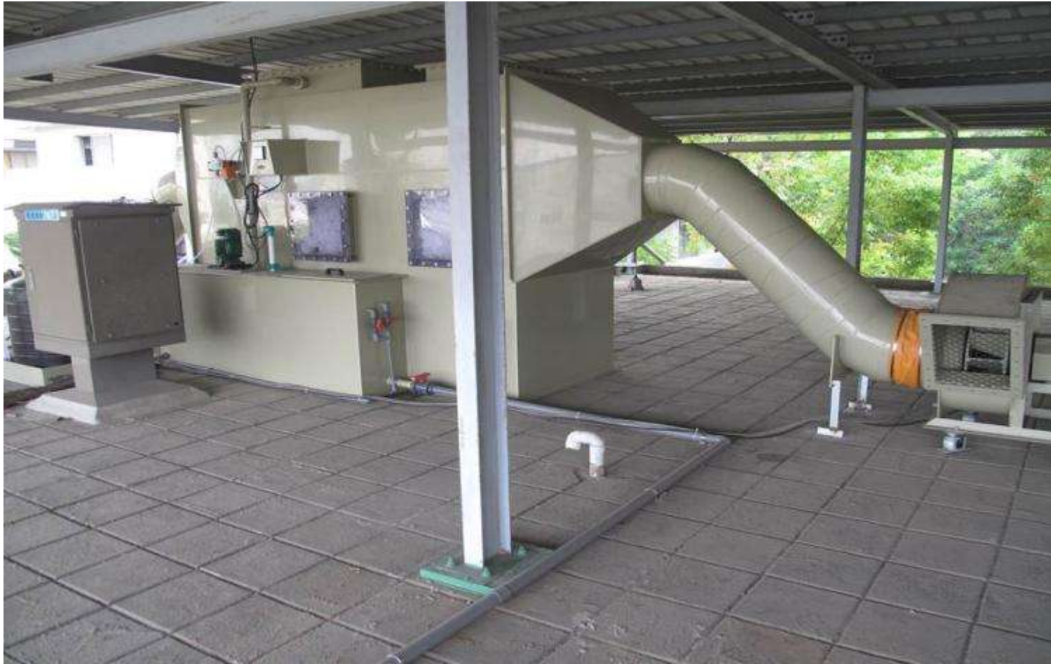
圖 49 前處理室水洗塔實景
