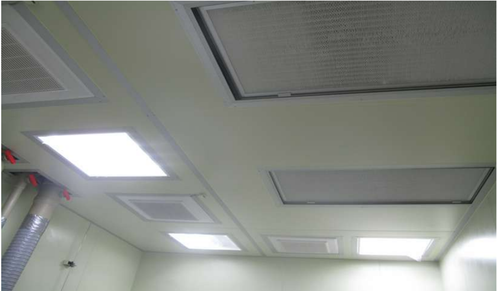
圖 52. 質譜儀器室高效率空氣過濾網裝置
