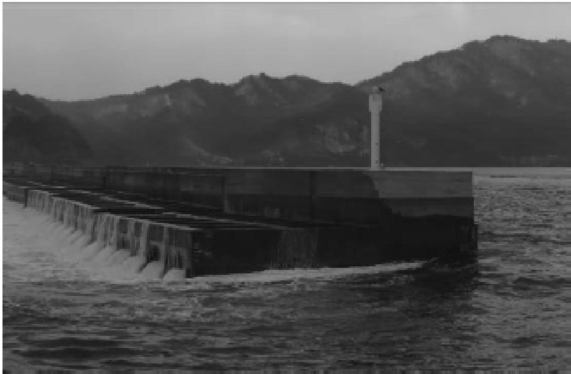
圖 16 釜石灣口防波堤損壞情形（南堤）[2]
