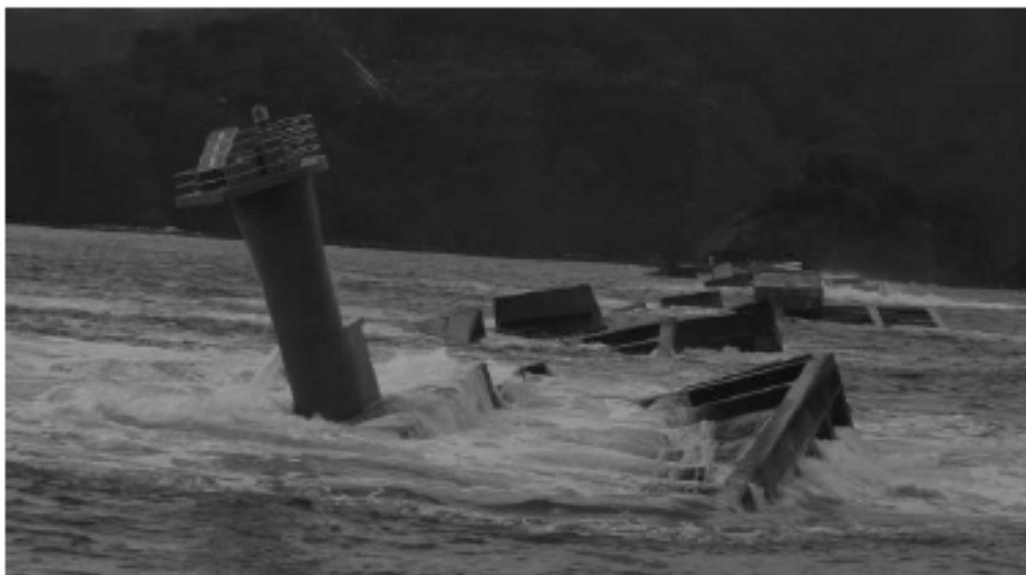
圖 15 釜石灣口防波堤損壞情形（北堤）[2]
