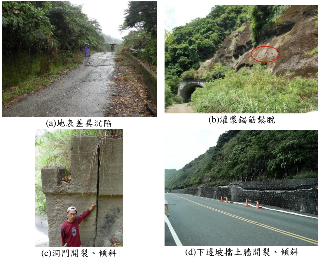
圖4.4-1 隧道外異常現象之特徵
