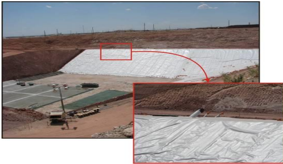
圖 10 安德魯低放處置設施安裝地層水份中子探測儀 (物管局，2011)
