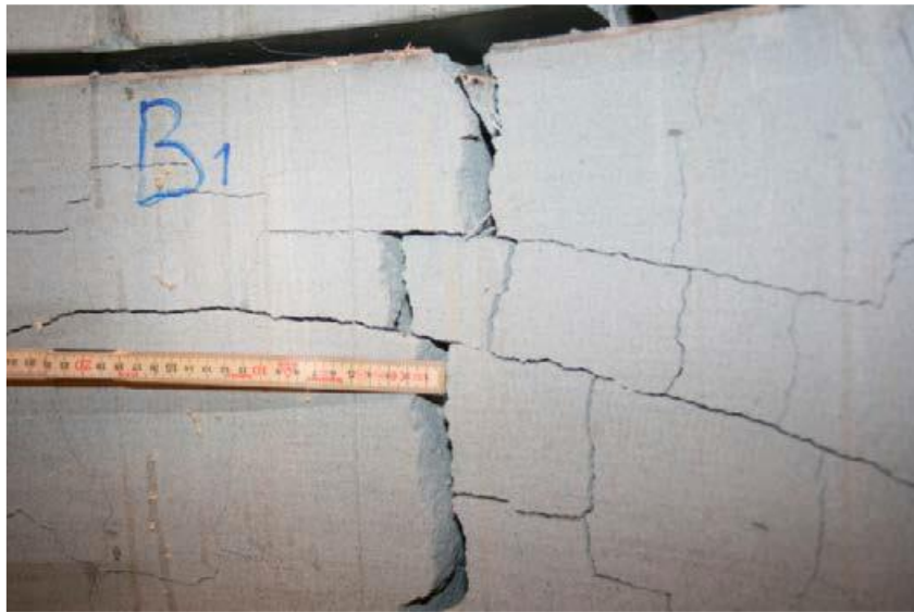
圖 2.23 緩衝材料內的裂紋
