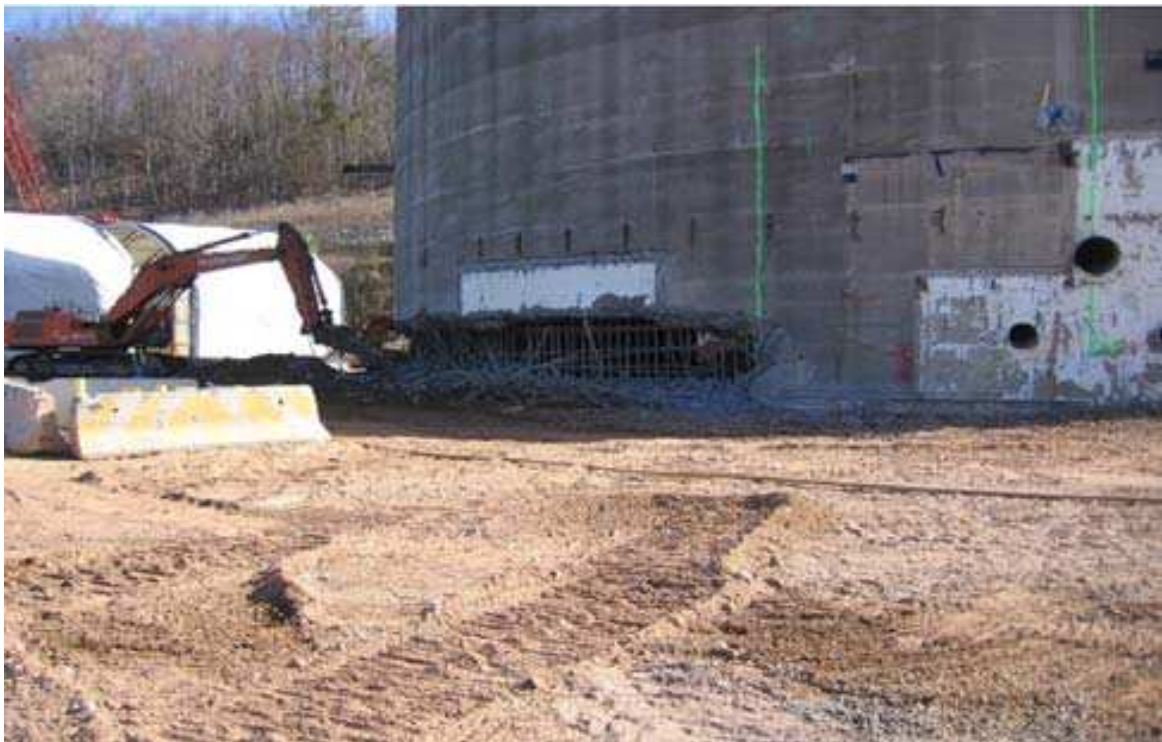
圖 3.19 剪切暴露的鋼筋
