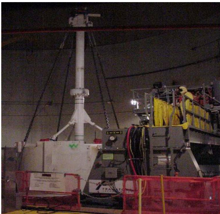
圖 4-10 協助內部組件舉升及定位的吊舉設備
