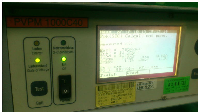
圖 4：PVPM 發電效率測量系統
