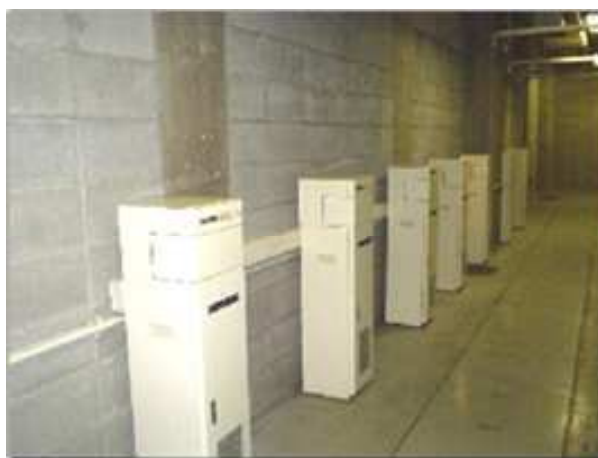
圖 2-10 獨立式自動滅火設備配置情形
