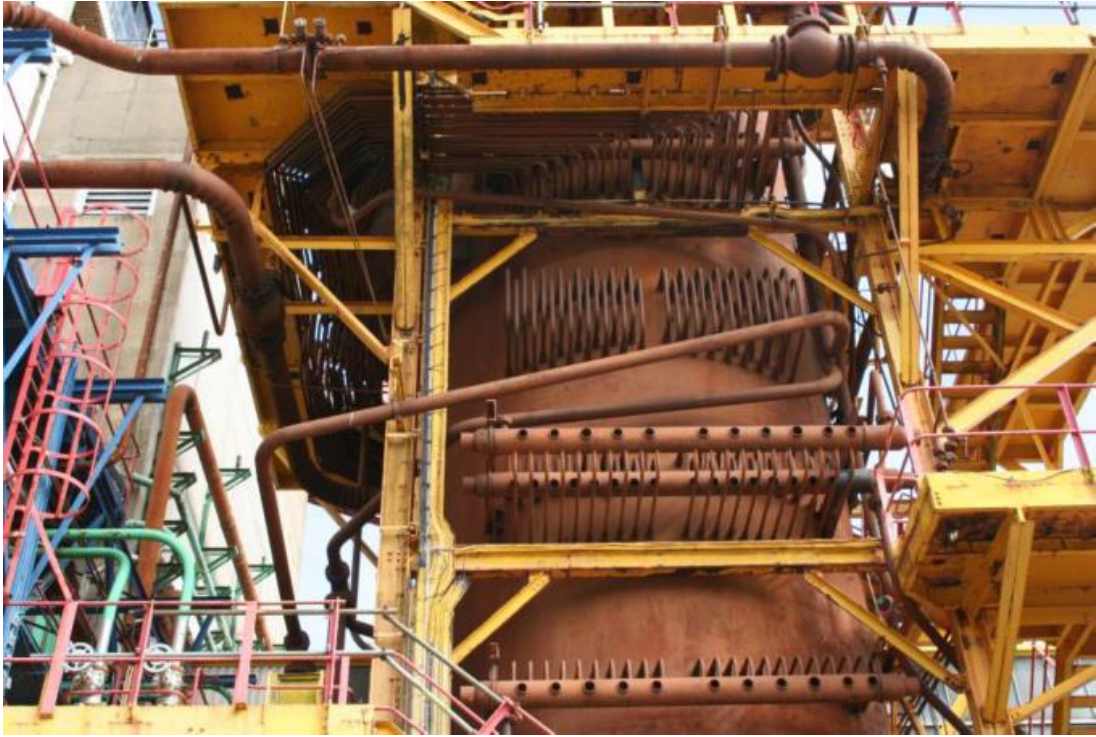
圖 4.13 熱交換器蒸氣系統小口徑的管線
