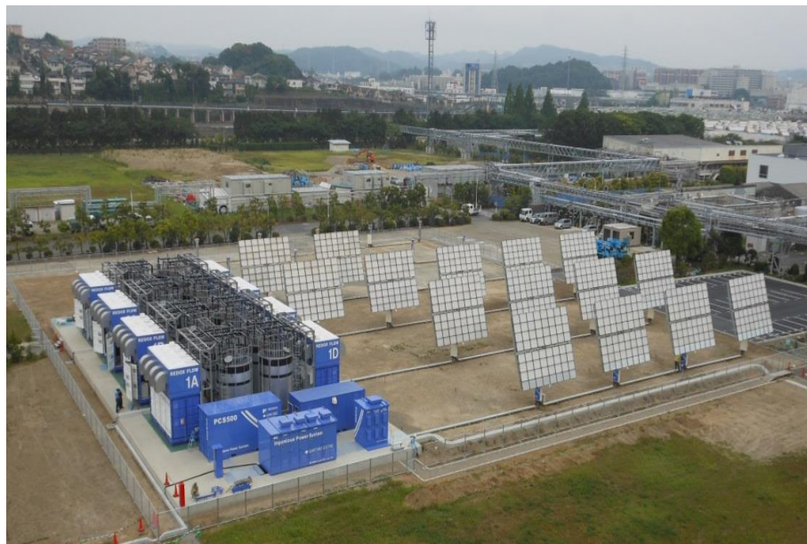
圖 1-2 住友電工在橫濱廠(Yokohama Works)建置1 MW/5 MWh的VRFB儲電系統[9]
