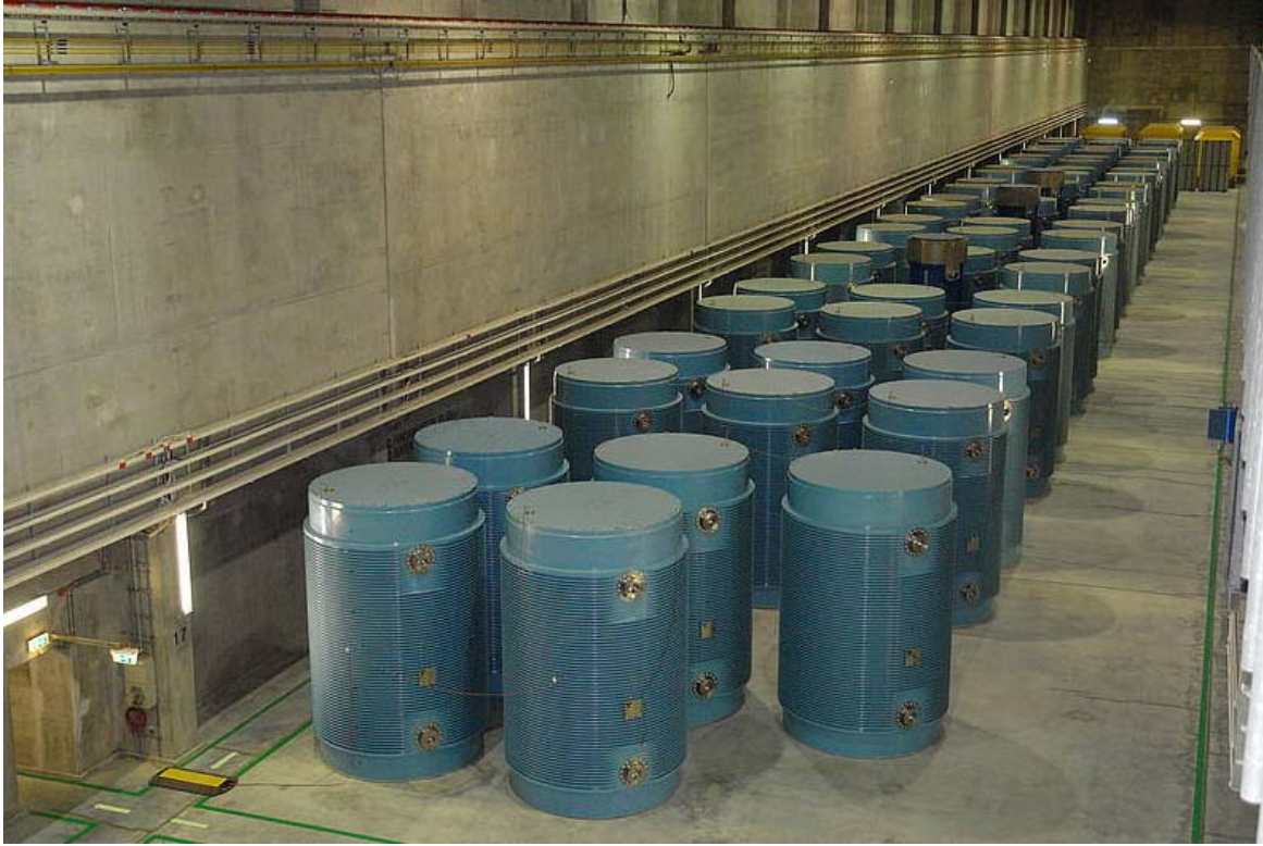
圖 3.3.1 德國 Greifswald 電廠乾式貯存設施
