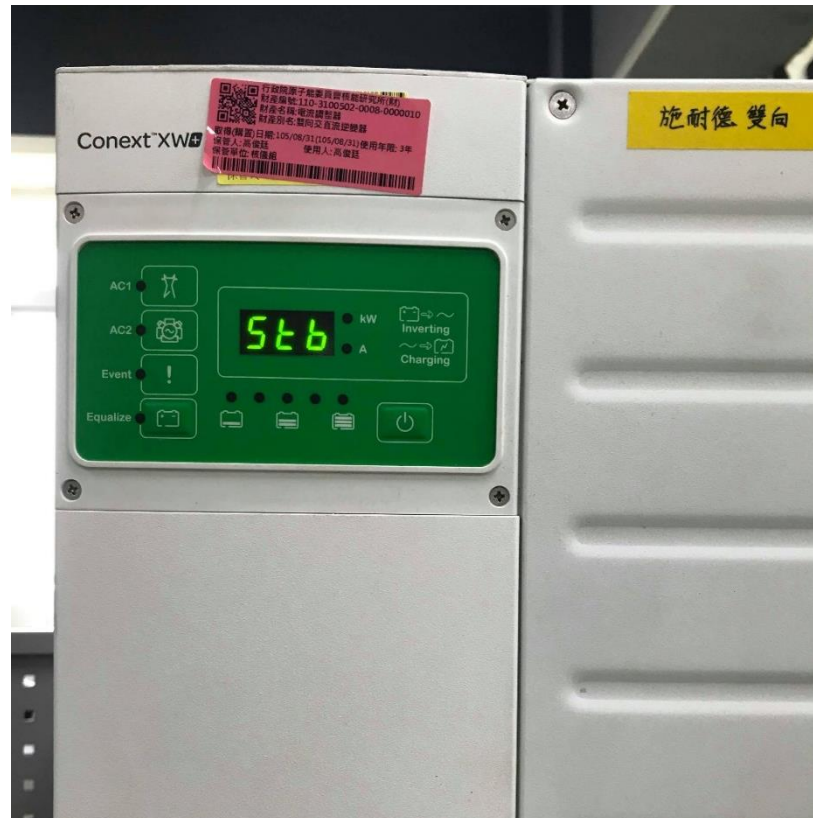
圖 2-3-2 施耐德儲能換流器之開機狀態
