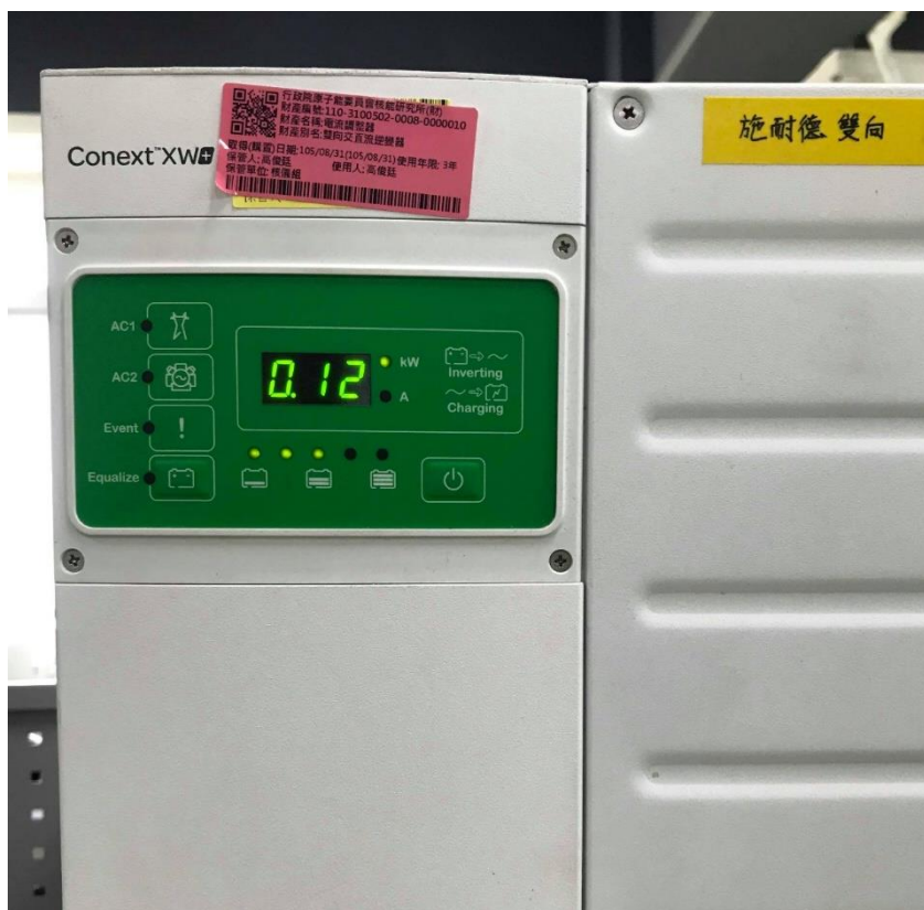
圖 2-3-4 施耐德儲能換流器之面板顯示
