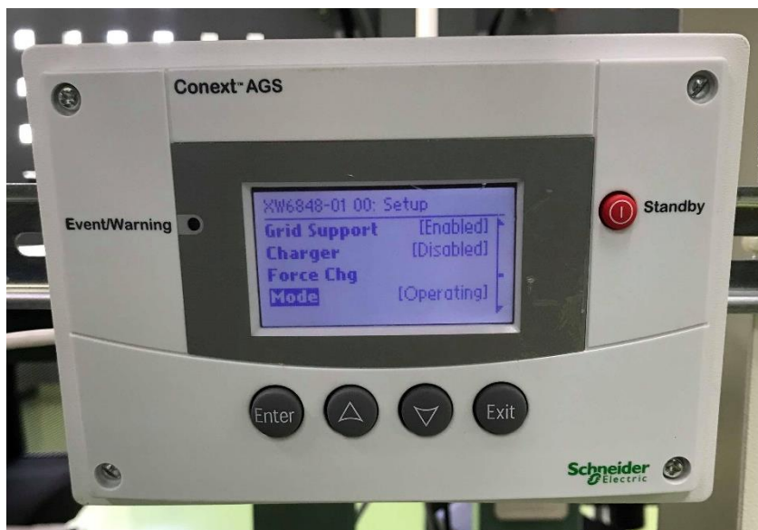
圖 2-3-3 施耐德儲能換流器的通訊轉換盒
