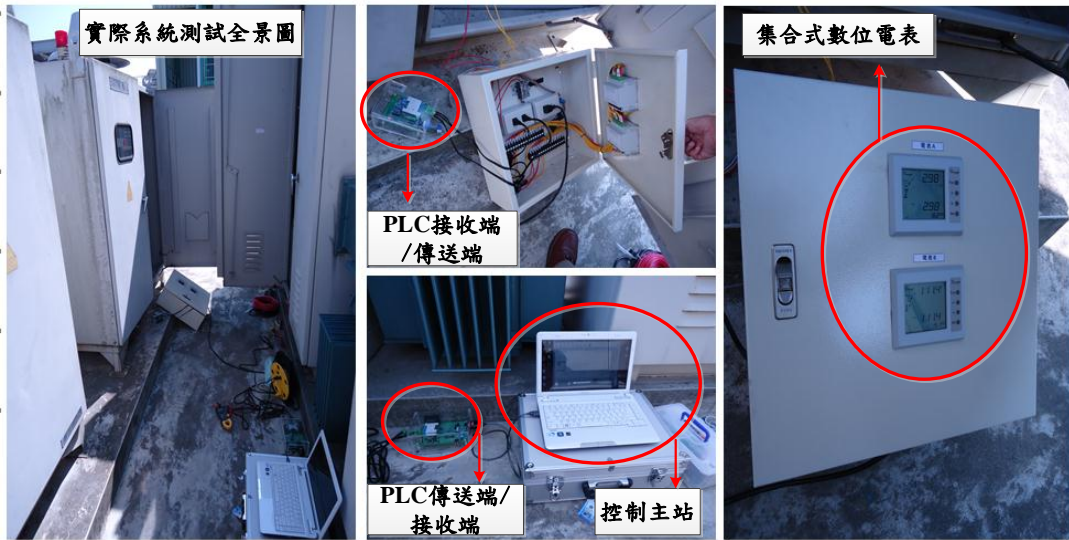
圖 2.41 PLC 實地設備擺置
