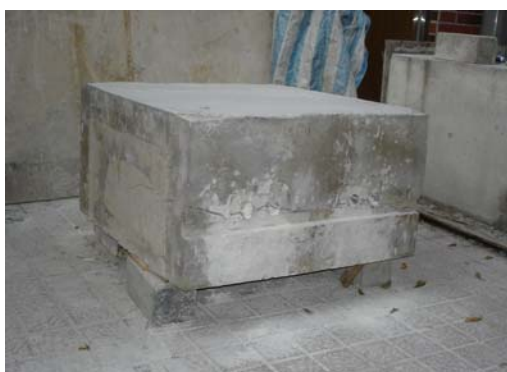
圖 37、膨脹水泥反應後，產生水平裂縫之情形
