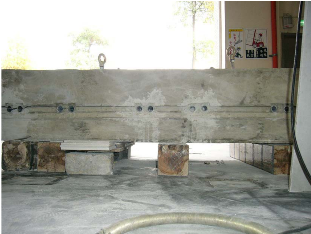
圖 56、僅預埋塑膠管試體開裂之情況(背面)
