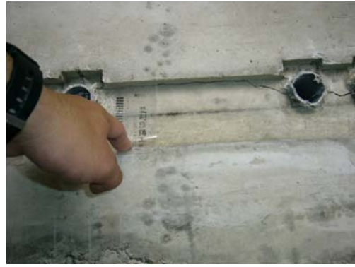
圖 53、預埋塑膠管試體(中間部分)之開裂
