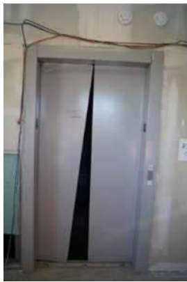
圖 5 BNCS 實驗結果，電梯門於地震後損毀情形
