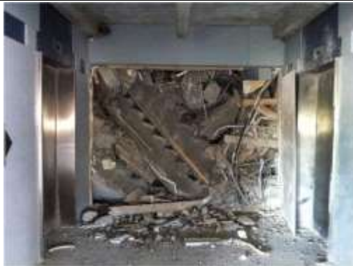
圖 3 2011 年基督城地震樓梯倒塌情形
