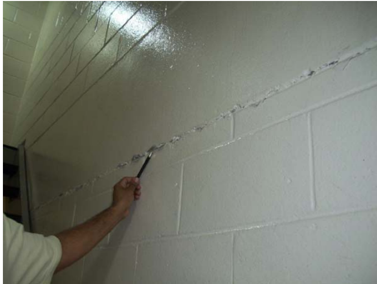
圖 7-40 NAPS 位於電梯施工界面產生水平裂縫
