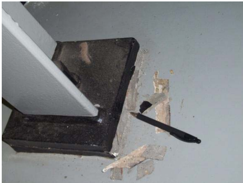
圖 7-41 NAPS 儲存槽錨固基礎底部剝落現象
